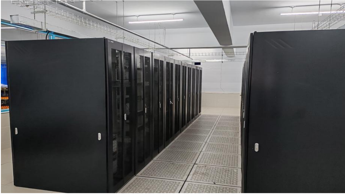
图 29：学校数据中心
